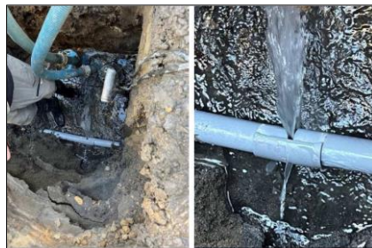
老朽管の経年劣化による漏水(年500件以上)
