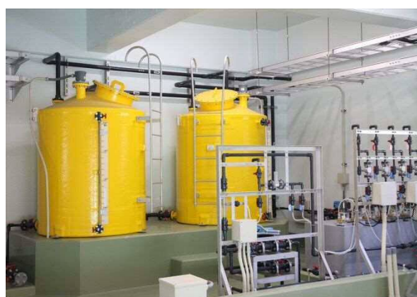
浄水処理設備 (塩素消毒)
