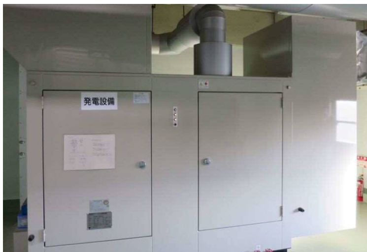
非常用自家発電設備
