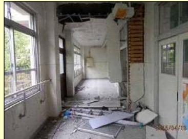
(廊下天井等の破損)
