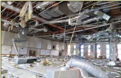
(最上階ホール天井の脱落)
