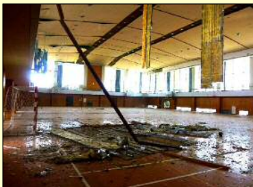
(天井・照明設備の脱落)
