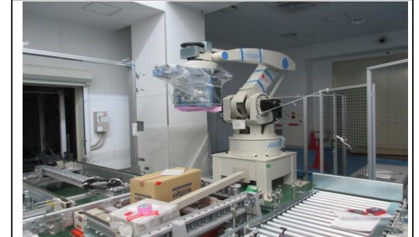
▲【ロボットパレタイザー】 製造された20ℓ・10ℓ箱やペットボトル箱製品をロボットがパレットに自動で積み付けする機械です。これにより省人化が図られます。
