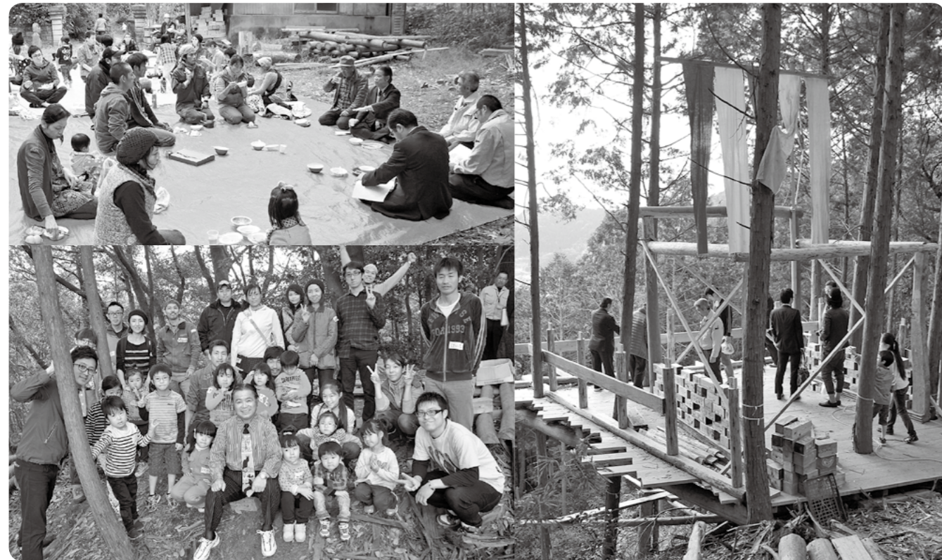
11月16日、地域おこしグループ「いちの木」と面談し、現在建築中のツリーハウスを視察
