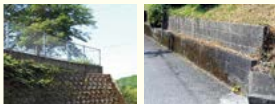
擁壁の上部に直接設置されている土留めを兼ねている
