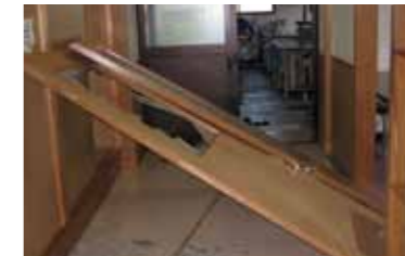
空振で外れた扉(2011.2.1/霧島公民館)
