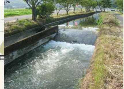
柵のない用水路 流れが速く、深い場所もあり危険
