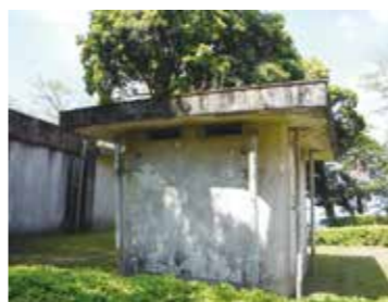
改修予定のトイレ
