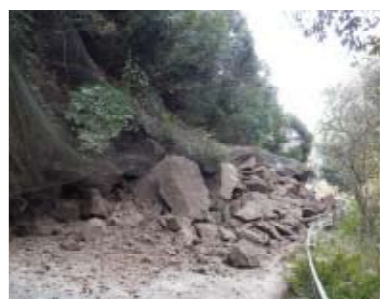
市道道場口～春山線の崩落現場
