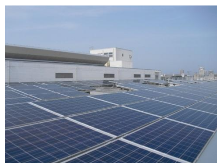
施設屋上に設置されている太陽光発電パネル
