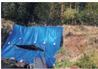
法面崩壊している隼人町小田の私有地
