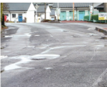
ひび割れ等のある市道
