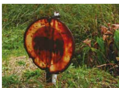
腐食した河川設置の防火水利看板
