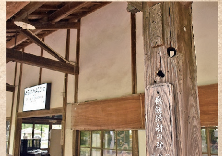
大隅横川駅柱の弾痕跡
